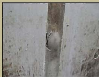
目地施工時に空気が混入し、外気温の上昇等で膨張し、破壊する
