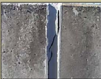
コンクリートの伸縮により目地材内部が破壊する
