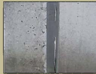
コンクリートと目地材の接着面が剥がれる破壊
