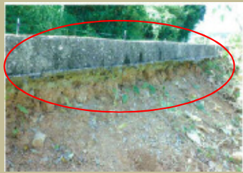
道路脇の法面が雨水等により洗掘されている。
