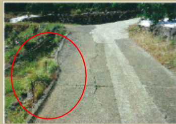
舗装時に水受けを行っているため洗掘されていない。
